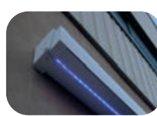
ÉCLAIRAGE LED STORE FERMÉ
